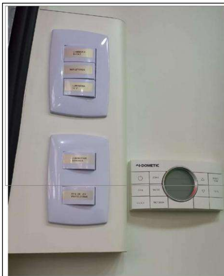
Figura 17: Modelo ilustrativo de interruptores de luz e ar-condicionado (desejável)
